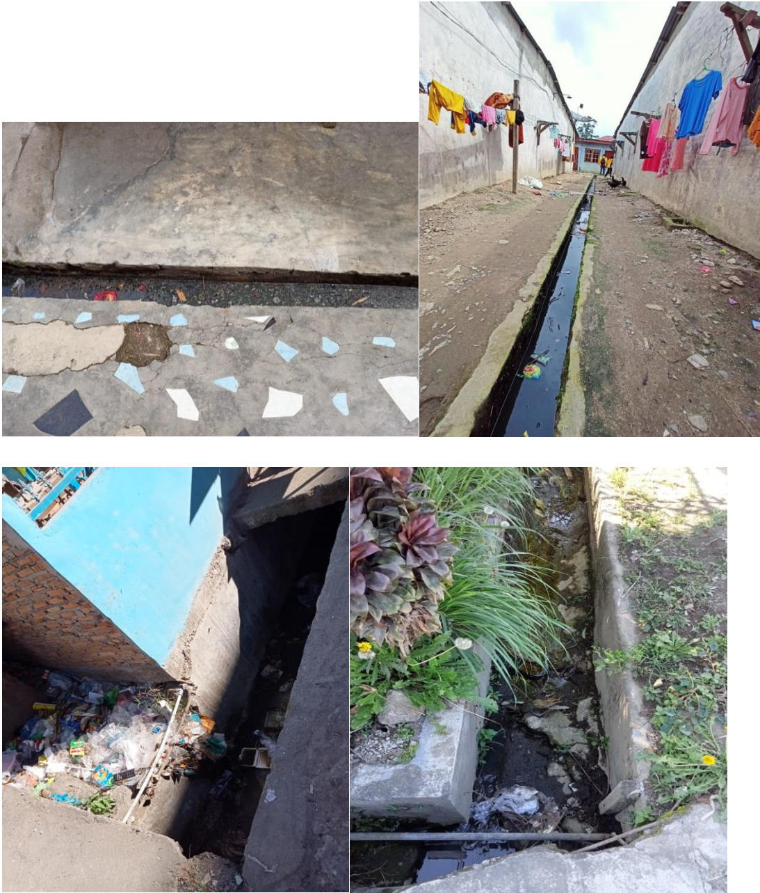
Kondisi saluran pembuangan air limbah yang tidak tertutup
