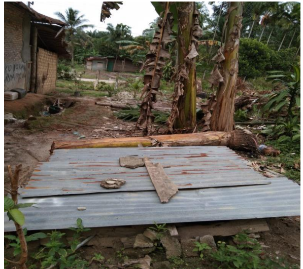
Jarak antara SPAL dengan Sumur Bor kurang dari 10 meter
