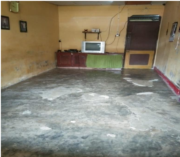
Kondisi lantai rumah yang retak
