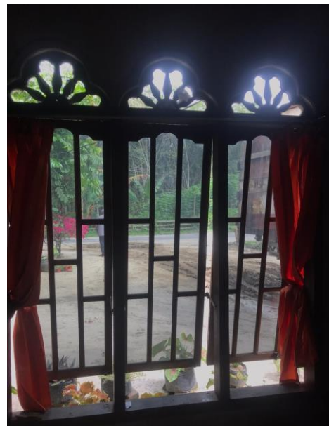
kondisi ventilasi yang lebih dari 10% luas lantai
