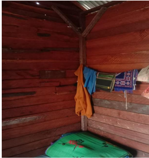
Gambar 4.1 Gambaran kondisi rumah ventilasi kurang dari 10%
