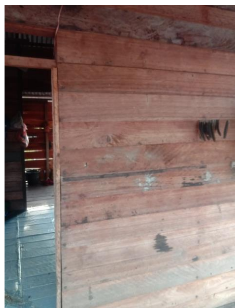
Dinding rumah yang tidak memenuhi syarat
