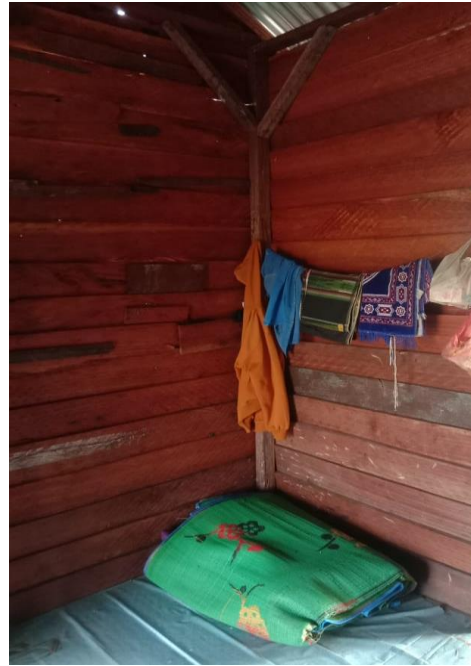
Rumah yang tidak memiliki ventilasi
