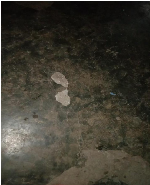
Lantai rumah yang sudah retak
