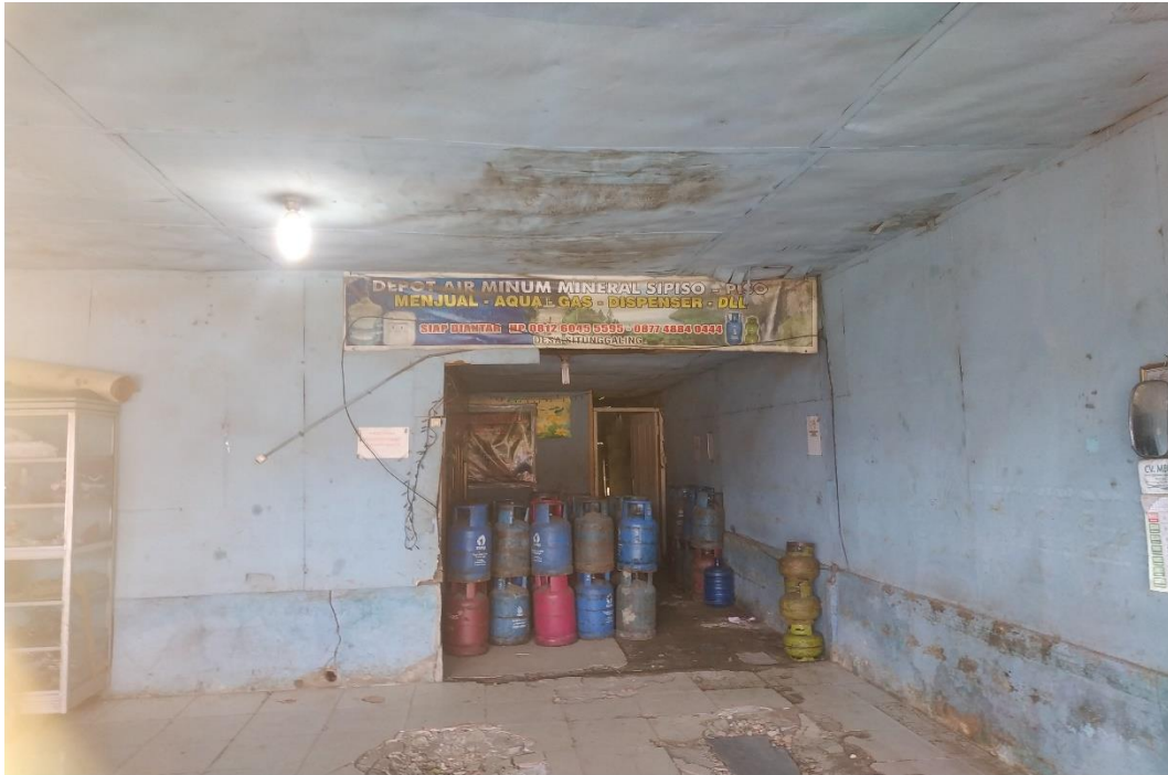
Kondisi Tembok dan Atap Depot Sipiso-piso Water
