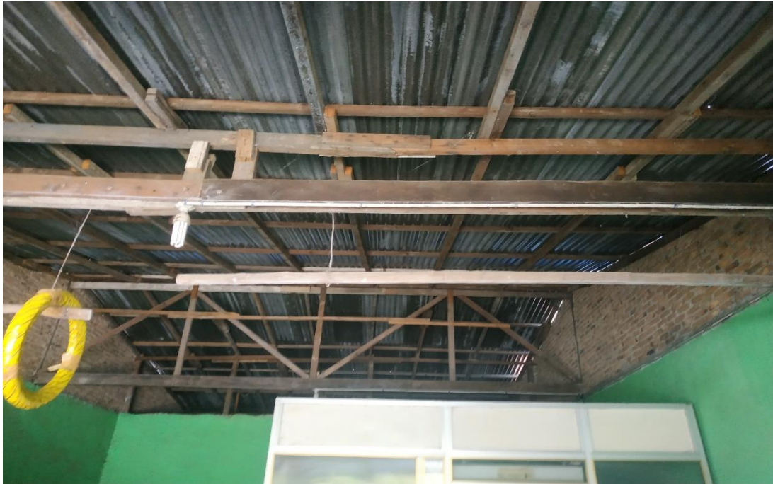
Kondisi Atap Ruangan Galon Sembiring Water
