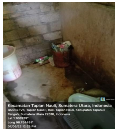
Kamar Mandi dan Toilet
