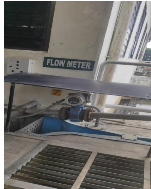
Flow Meter (Pengukur Debit Air Limbah )
