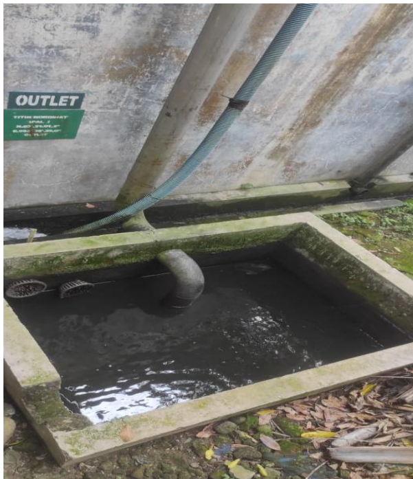
Bak Indikator ( Outlet )Tahap Akhir
