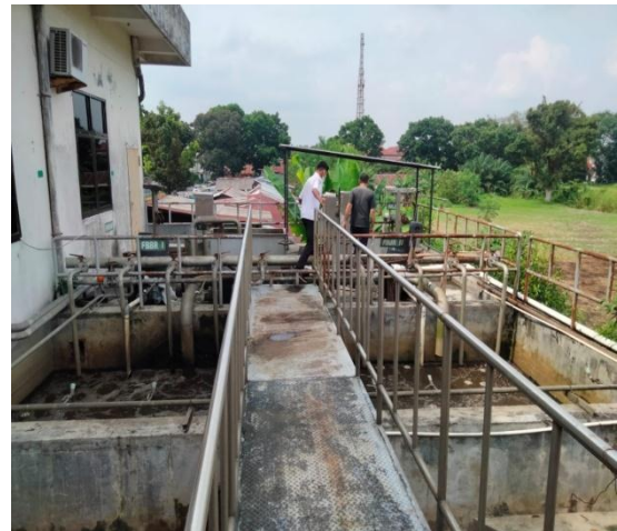
Bak FBBR I dan II (Bak Perkembangbiakan Bakteri )
