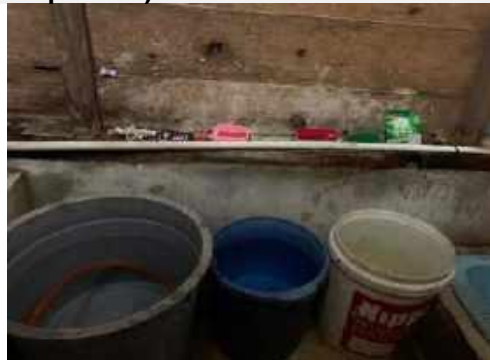
Kondisi jamban warga
