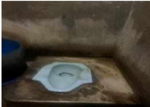
Kondisi jamban warga
