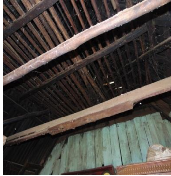
Gambar 2. Rumah yang tidak memiliki ventilasi
